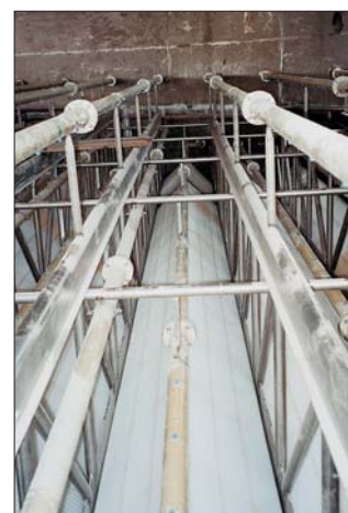
烟气脱硫塔内的LTV110，俯视
