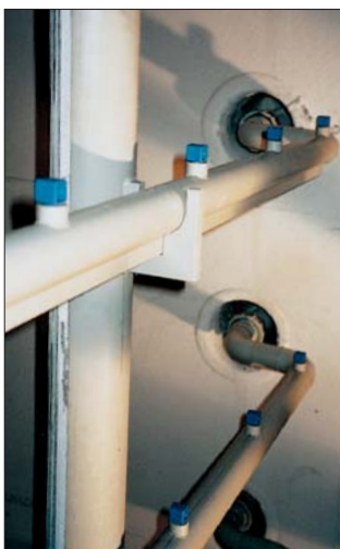
冲洗系统的局部
