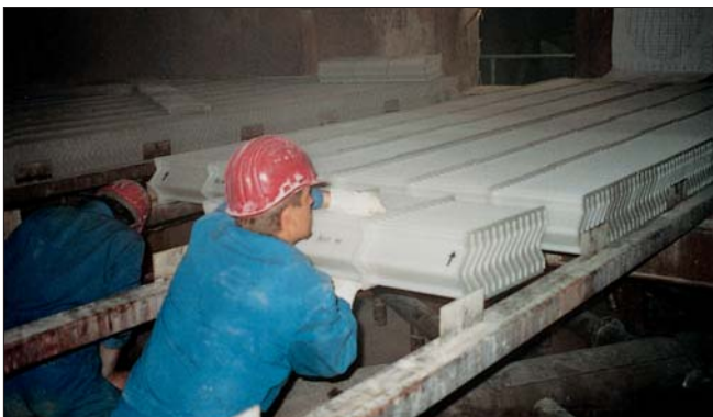
在烟气脱硫塔内安装塑料材质的LTV400
