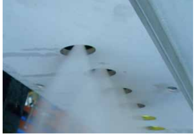
运行中的有盖板的集管喷射
