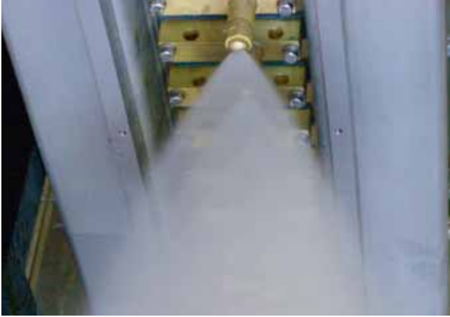
运行中的莱克勒气雾喷嘴集管
