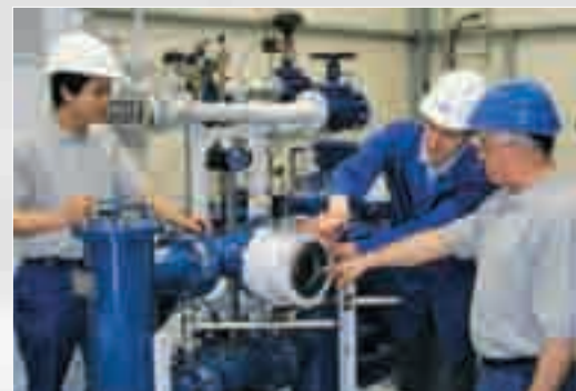
Inbetriebnahme und Schulung durch Lechler Mitarbeiter
